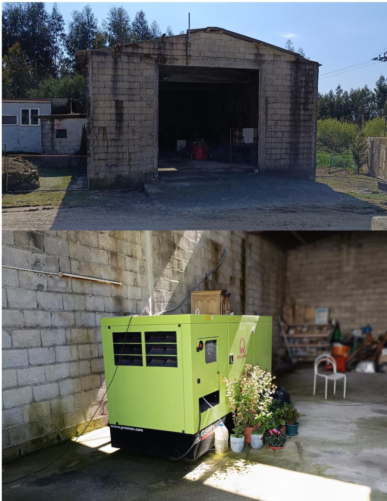
Figura 3.1.4. Vista do armazém e gerador de emergência no seu interior
